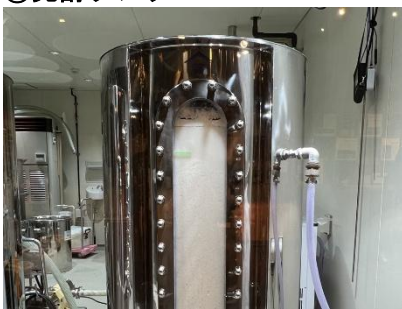
④発酵タンク
