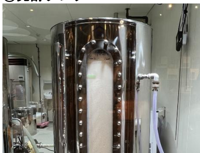
④発酵タンク
